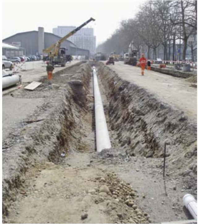
4: Linienbaustelle (Gas/Wasser) in 15 m Abstand zur Papiermühle-Allee und auf dem Parkplatz der grossen Allmend. Blick Richtung Süden/Guisanplatz. Im Hintergrund links: Festhalle der BEAexpo.
