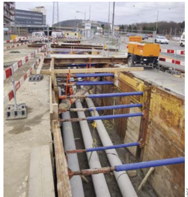
7: Grabenbau (Gas, Wasser) ausserhalb des Strassenraumes nördlich des Wankdorfplatzes, im Bereich des neuen Audi-Centers der AMAG. Blick Richtung Norden. Die neuen Leitungen queren die zahlreich vorhandenen bestehenden Werkleitungen.
