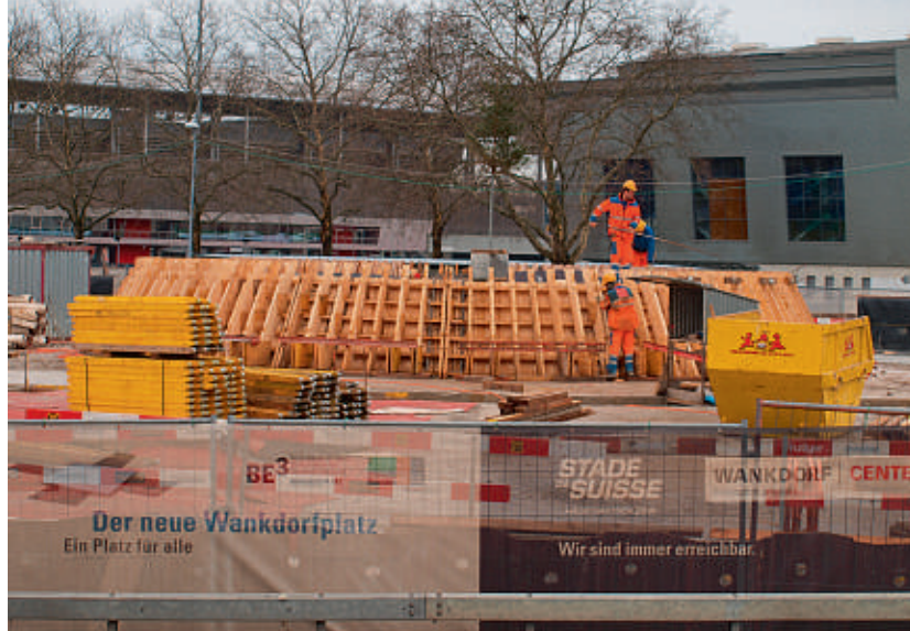
Januar 2011: Der Deckel ist drauf, Arbeiter bringen die Schalung für die Kreiselloffnung an.
