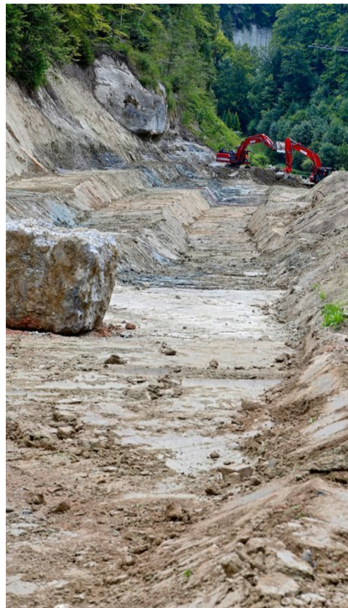
Aufwendiger Strassenbau: Damit der Druck der Fahrbahn besser verteilt werden kann, basiert das Fundament auf unterschiedlichen Niveaus.
